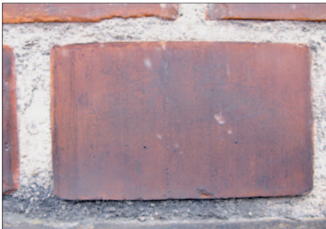
Abb. links: Ursprünglicher Zustand einer Klinkerfassade mit mittlerem Verschmutzungsgrad
